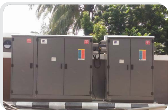
11kV Motorised RMU
